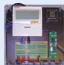
Printkana pločica, transformator napajanja, terminalski blok
